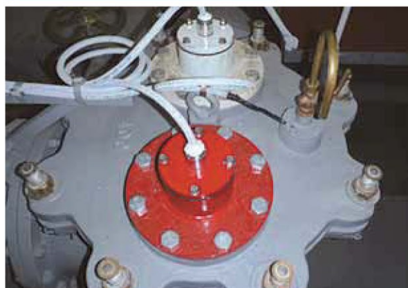
冷却海水ポンプの入り口側ストレーナーに電極を取り付けたタイプ
