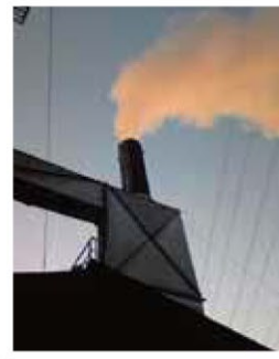
A重油のみ燃焼状態
